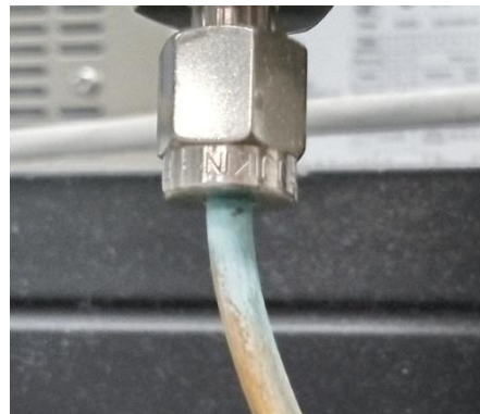
図1 銅のガス配管に発生した緑青
